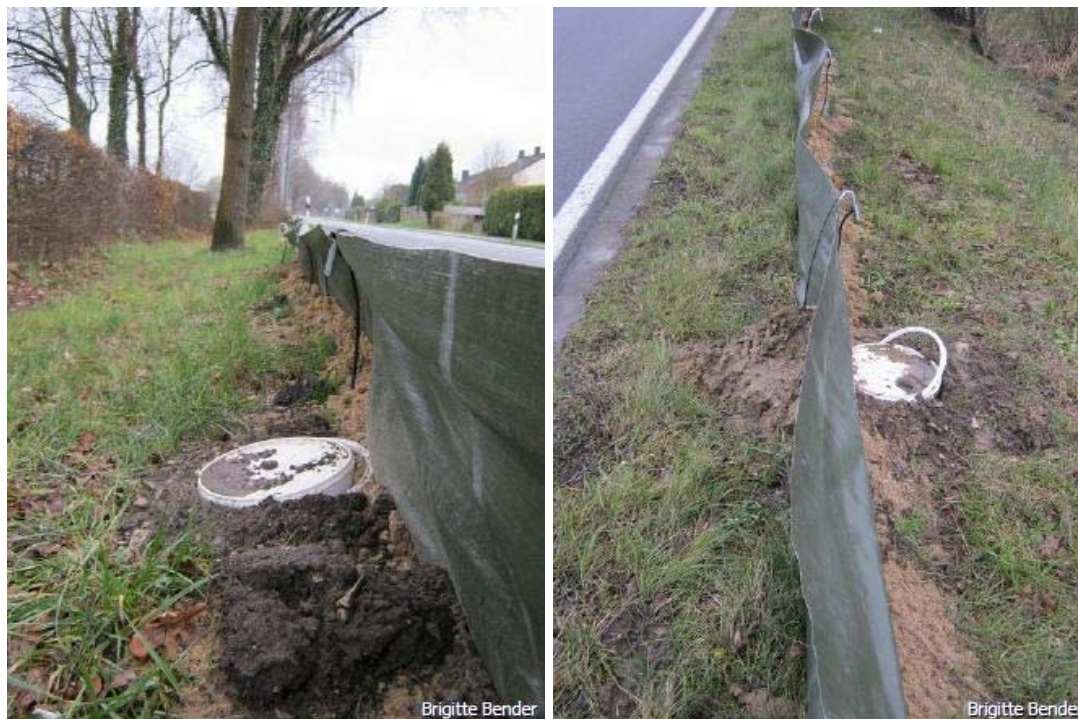
Abb. 5-6: Schräg eingebaute Eimer sind nicht fachgerecht. Auch ist es schwierig die Folie und Zaun direkt aneinander zu bekommen. Hier wurde Erde an den Zaun gedrückt um die Folie an den Eimer zu schieben. Fotos: Biggi Bender
