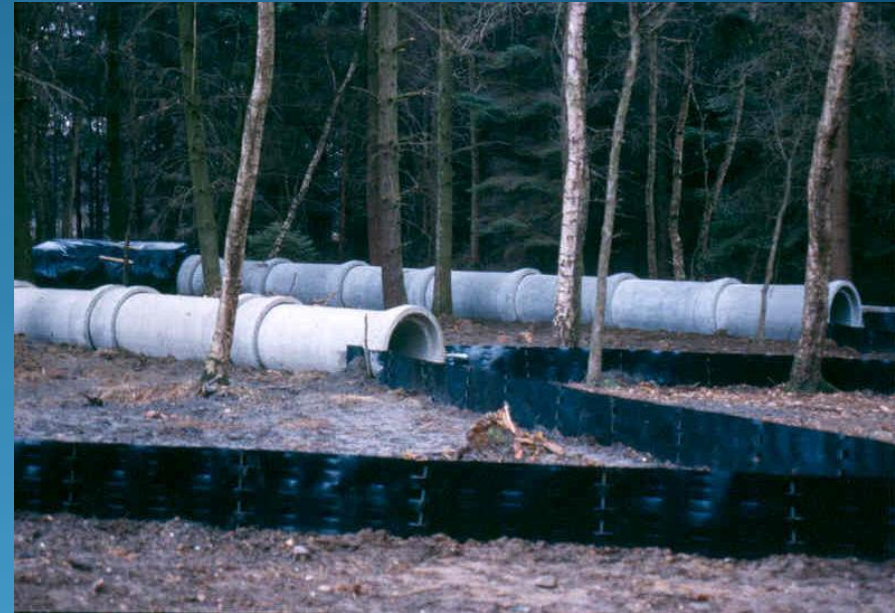
Forschungsanlage durch Uni Bonn im Rahmen F& E Forschungsprojekt der BAST R. Dixel (1986-1987)
